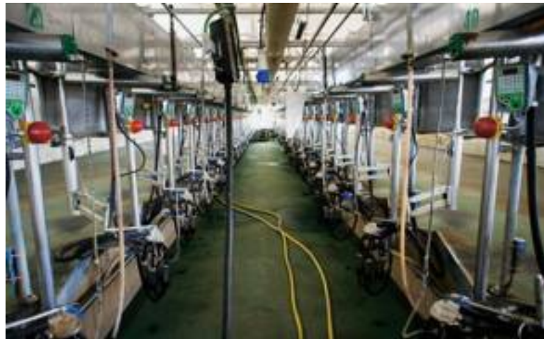
● Per essere efficiente, l'impianto di mungitura deve funzionare bene ed essere mantenuto bene in funzione. Uno dei parametri su cui ci si basa per capire se l'impianto è efficiente è la misurazione del "livello di vuoto operativo".
