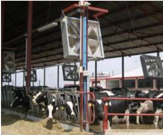
● Nella stalla per bovine da latte la ventilazione artificiale può essere realizzata attraverso ventilatori elicoidali con diametro variabile, attivati da motori elettrici.
