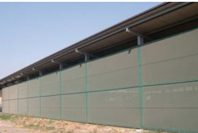
● Negli ultimi anni si è diffuso un modello di stalla sempre più aperto, soprattutto sui lati lunghi della stalla. Questi nel periodo invernale vengono chiusi utilizzando reti frangivento, teli plastici, file di balloni e così via.
