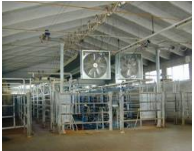
● I sistemi di ventilazione diventano particolarmente strategici nella zona di attesa mungitura, tanto più quanto più gli animali devono attendere per entrare, e nella zona di alimentazione. Nella foto abbiamo un esempio di ventilatori ad asse orizzontale.
